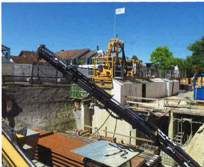
Hinter dem Seewasserwerk Kesswil wurde die Baustelleneinrichtung inklusive der Aufbereitungsanlage für die Bohrflüssigkeit untergebracht.
