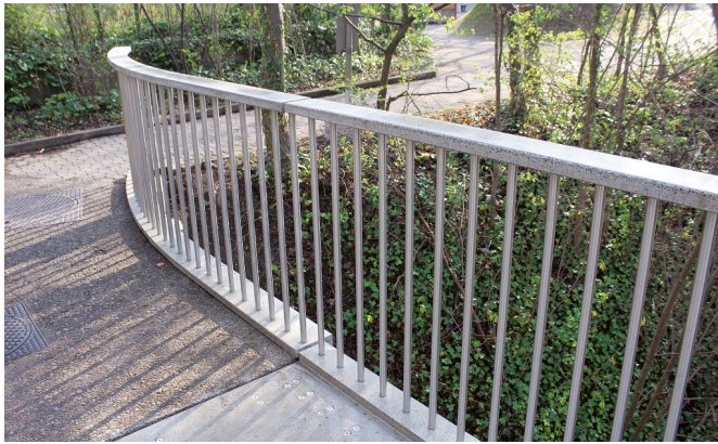
Bild 5 Übergang vom Geländer der Brücke zum Geländer der Zufahrt (ZHAW) The railings of the bridge continue on the approaching paths (ZHAW)
