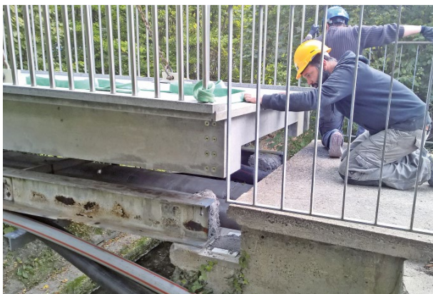
Bild 12 Einheben der Brücke mit dem Mobilkran (Silidur AG) The new bridge is placed on the supports by a mobile crane (Silidur AG)
