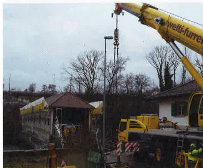
Der zur Abmontage verwendete Kran hat 70 Meter Standardauslegerlänge, 45 Meter maximale Klappauslegerlänge und bis zu 250 Tonnen Traglast.
