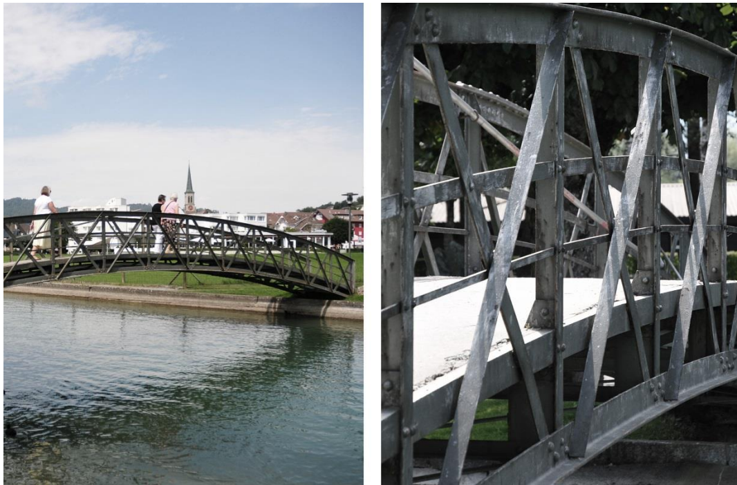
Abbildung 1: Bogenbrücke über die Lorze in Unterägeri vor der Instandsetzung
