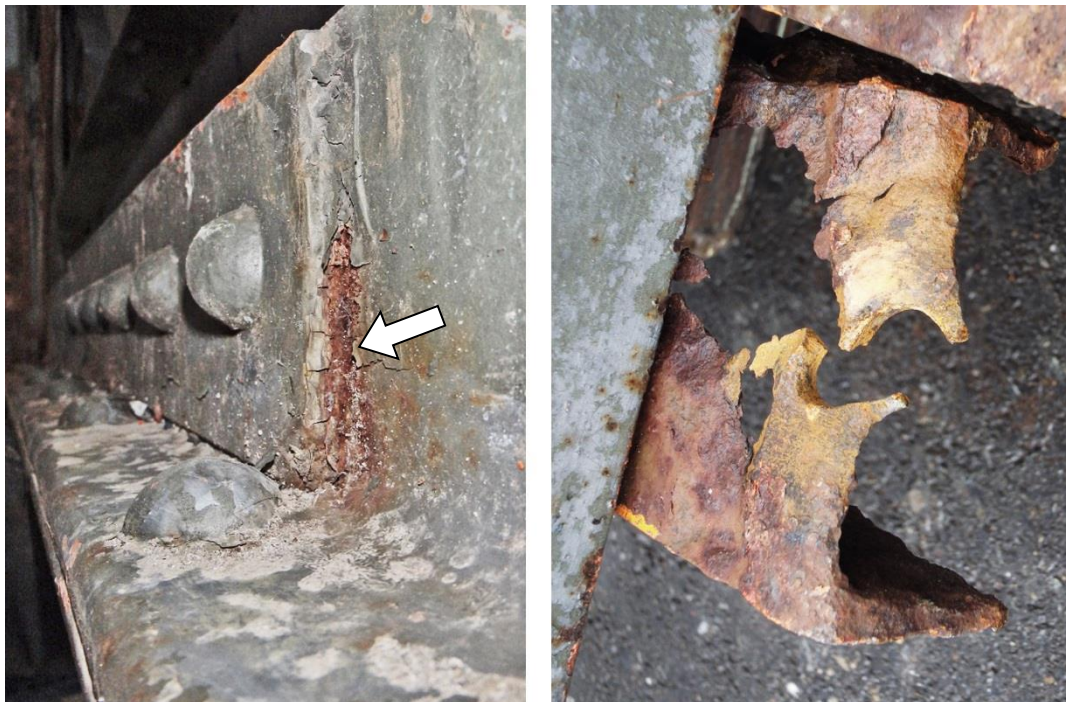
Abbildung 2: Brückenteile nach der Demontage; Spaltkorrosion in der Nietverbindung (links, weisser Pfeil), beinahe vollständig korrodiertes Stahlprofil (rechts)
